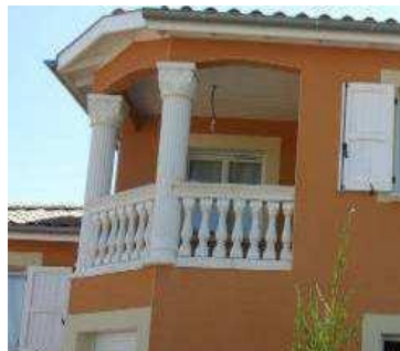
Type de balustres interdites
