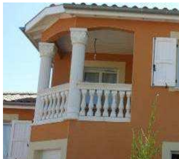
Type de balustres interdites
